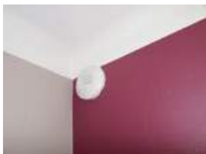
• Une VMC pour mieux ventiler un logement et combattre l'humidité
