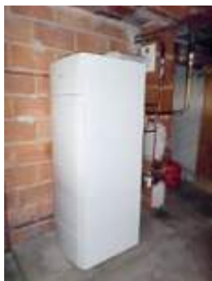
• Une nouvelle chaudière économe en énergie
