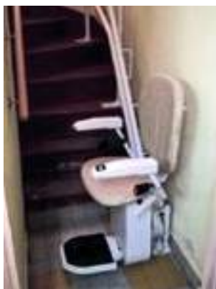
• Un monte escalier pour une personne en perte d'autonomie
